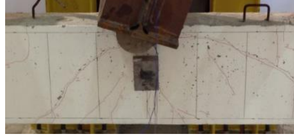
Şekil 7. Deney 2 numunesi hasar durumu
